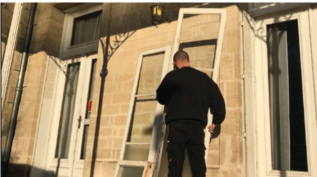
Rénovation des bâtiments municipaux pour des économies d'énergie : gymnase Boyer et Langevin, Hôtel de Ville, ex-Trésorerie, Maison de l'Enfant et des Parents
